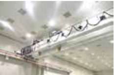
クレーン 4.8t 2基
