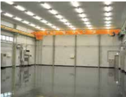
第2工場クリーンルーム クラス 100,000 広さ 424㎡
