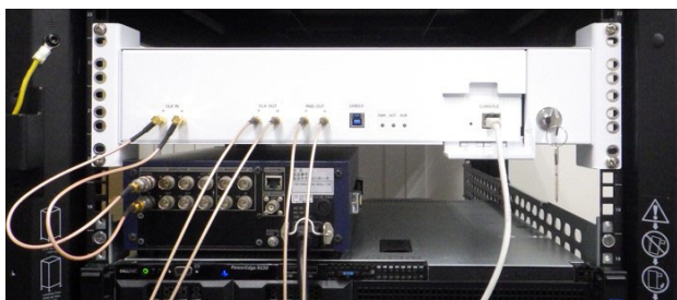
QKD装置との接続(外部クロック同期)
